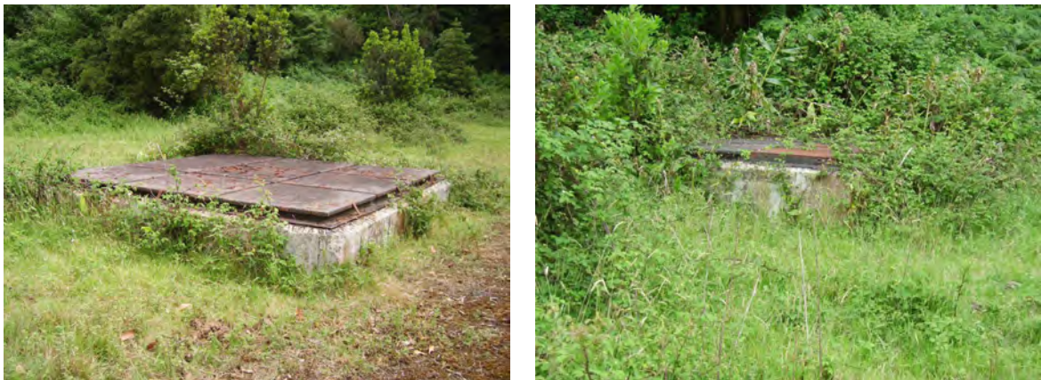
Figura 3 – Depósitos subterrâneos existentes em Pico Celeiro.
