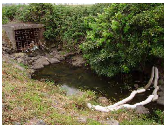
Fig. 64 – Pormenor de uma bóia de retenção de hidrocarbonetos à saída do north storm sewer drainage outfall
