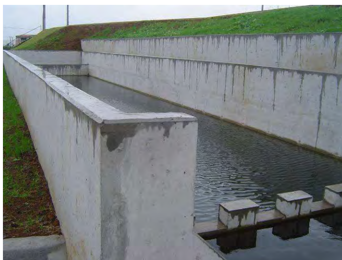
Fig. 57 – Tanque separador de águas e de óleos na South Tank Farm
